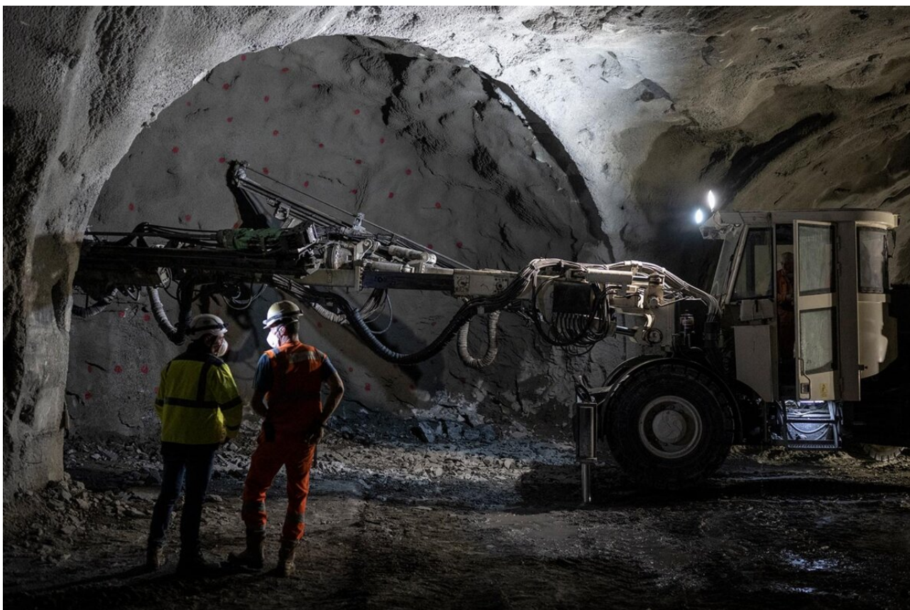
Sur le chantier de construction d'un tunnel pour la ligne de train entre Lyon et Turin, à Chiomonte, en Italie, le 18 janvier 2023. © Photo Marco Bertorello / AFP
